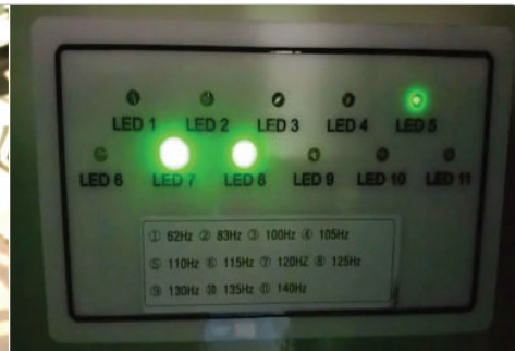
해당 회전기기 진동주파수 측정 (자가발전 진동주파수 측정장치_현팅)
